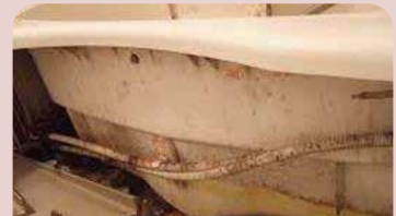
見えない部分が、こんなに汚れています
